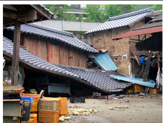
1階部分が潰れ2階部分が覆いかぶさっている家
