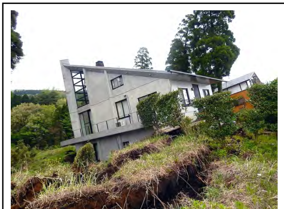
地盤が傾き、今にも沢に転落しそうになっている建物
