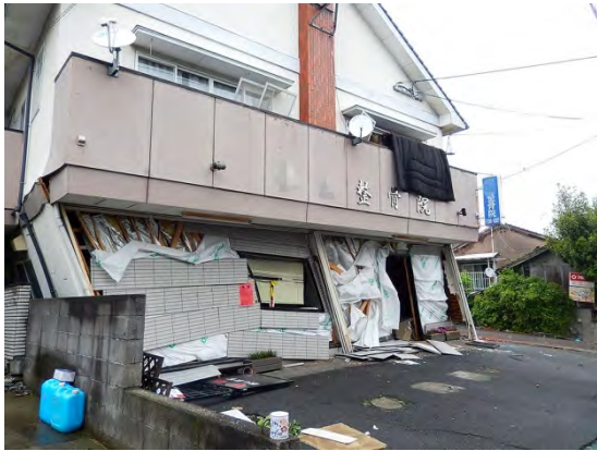
1階部分が変形し、今にも倒壊しそうな状態の家屋
