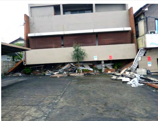
1階部分が座屈し、完全に押し潰されているビル
